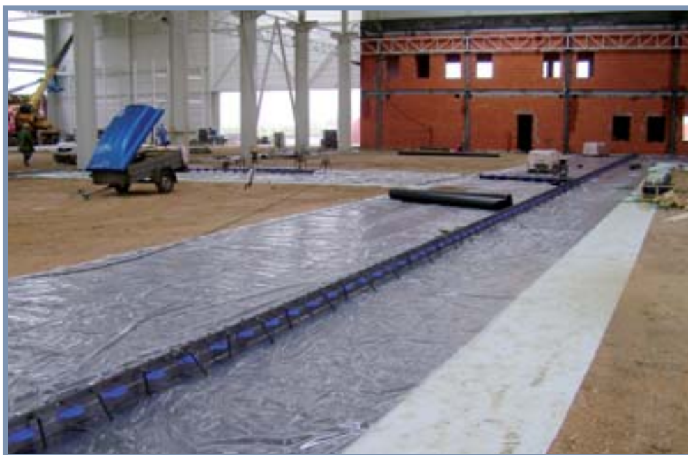
Peikon Slovakian Deltabeam tehtaan lattian rakenteissa käytetään TERA Jointia
